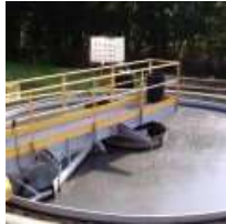
Vasca di sedimentazione primaria
