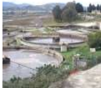
Vasche di sedimentazione
